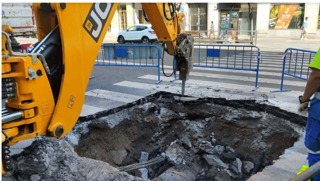
La máquina junto a la tubería rajada en el Paseo de la Estación.
